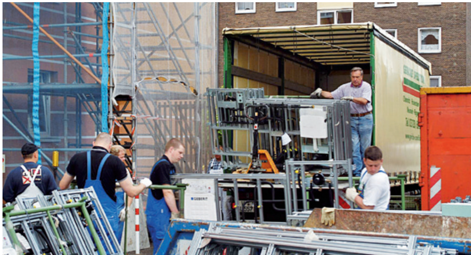
↑ Gotowe do instalacji, prefabrykowane ścianki instalacyjne systemu Geberit GIS dostarczone w samą porę na plac budowy.
