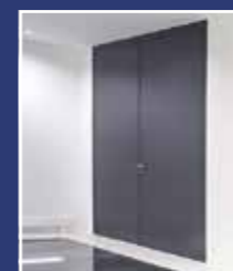
Drzwi przeciwpożarowe ze stali
